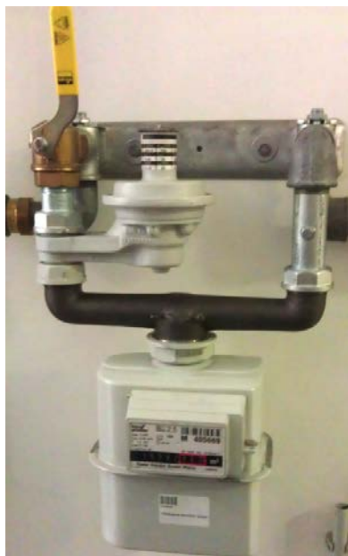
Abbildung 8.1: Einrohr-Gaszähler mit Passstück an einer Zweirohr-Gaszählerplatte mit Zählerregler
